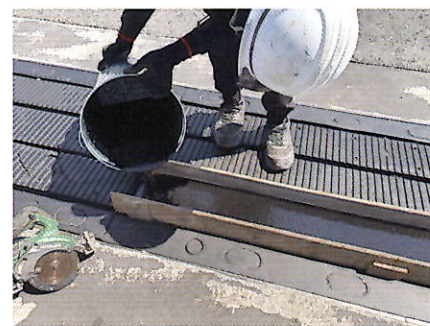
補修箇所に型枠をつくり、材料を攪拌したものを流し込む。
